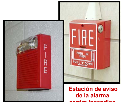
Bocina con estroboscopio de la alarma contra incendios
